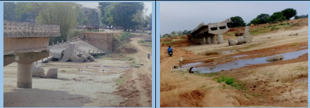
चित्र 2.9: सिसई प्रखंड में बालखटंगा-लोरेनगो सड़क के बीच दक्षिणी कोयल नदी पर बने ढहे पुल की तस्वीर
